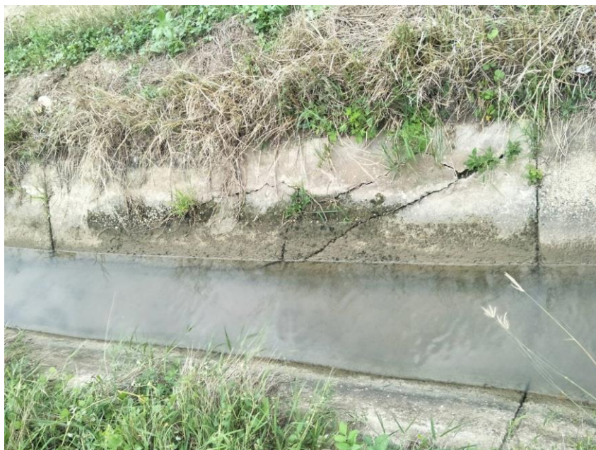
คูส่งน้ำมีสภาพ คอนกรีตแตกแตกกร้าวร้าวซึม
