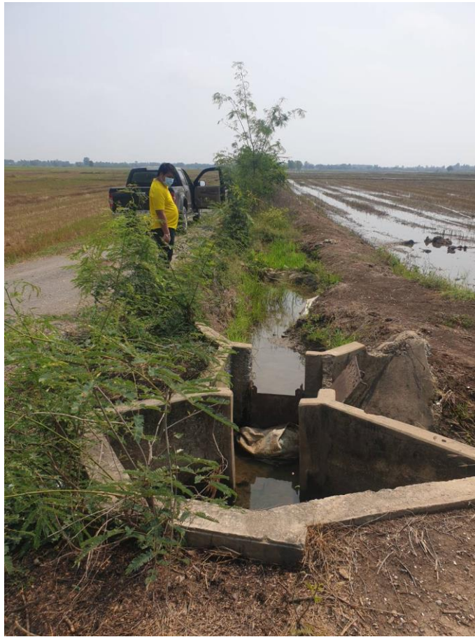
คูส่งน้ำมีสภาพ อาคารชำรุด ไม่สามารถส่งน้ำได้อย่างมีประสิทธิภาพ
